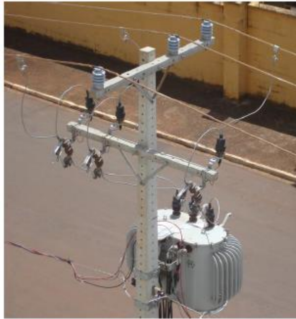
Figura 2.4 Exemplo de Posto de transformação na distribuição
