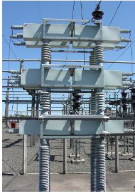
Figura 2.5 Exemplo de Banco de Capacitores alocado em uma subestação
