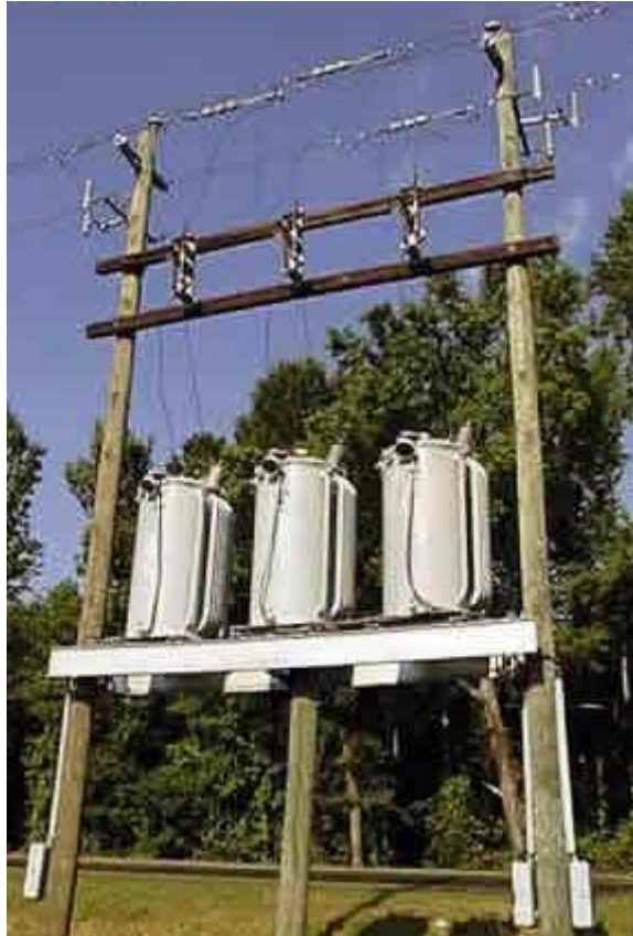
Figura 2.6 Exemplo de Banco de reguladores de tensão monofásicos
