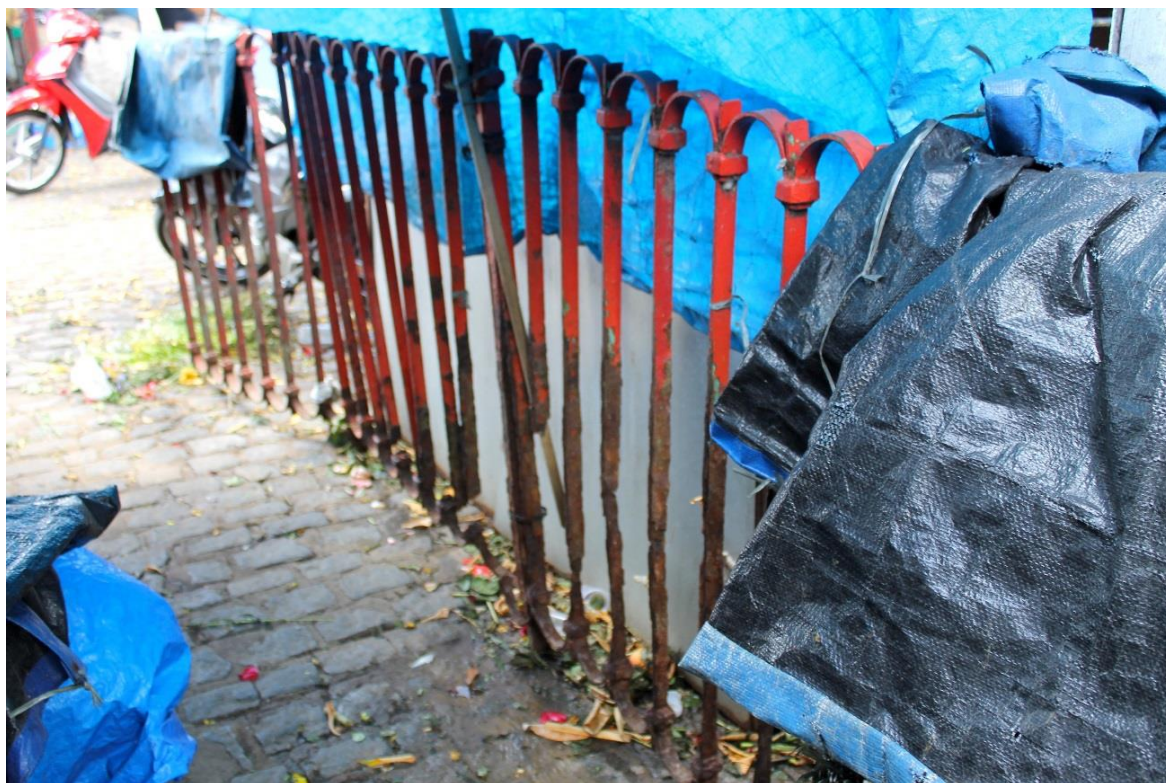
Figura 47 – Corrosão da grade de proteção no pátio da Feira Livre Casa Amarela Fonte: Rogério Cavalcanti, 2014
