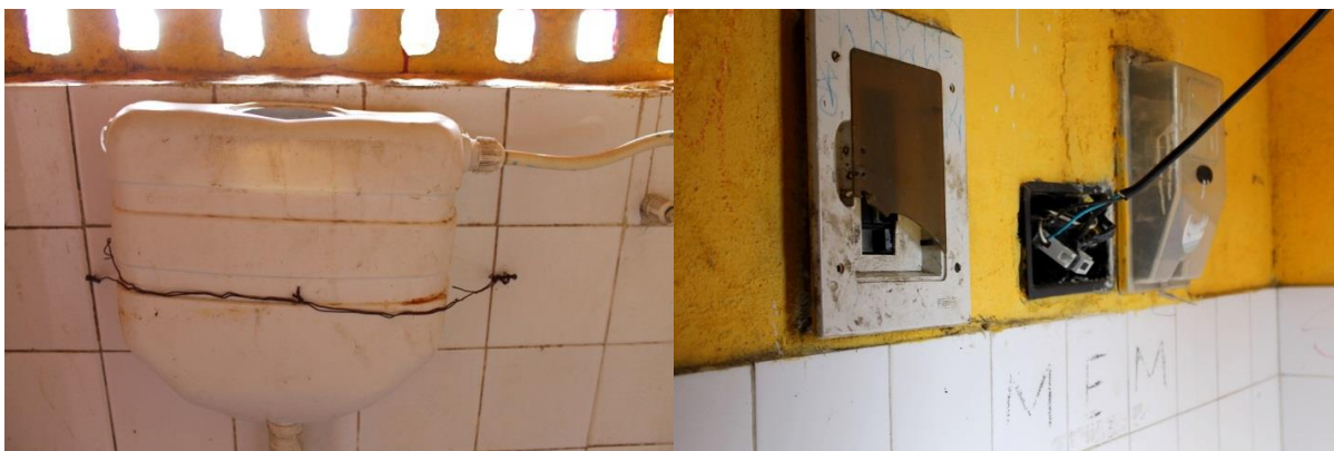
Figura 32 – Condições de infraestrutura do sanitário masculino da Feira Livre Casa Amarela Fonte: Rogério Cavalcanti, 2014
