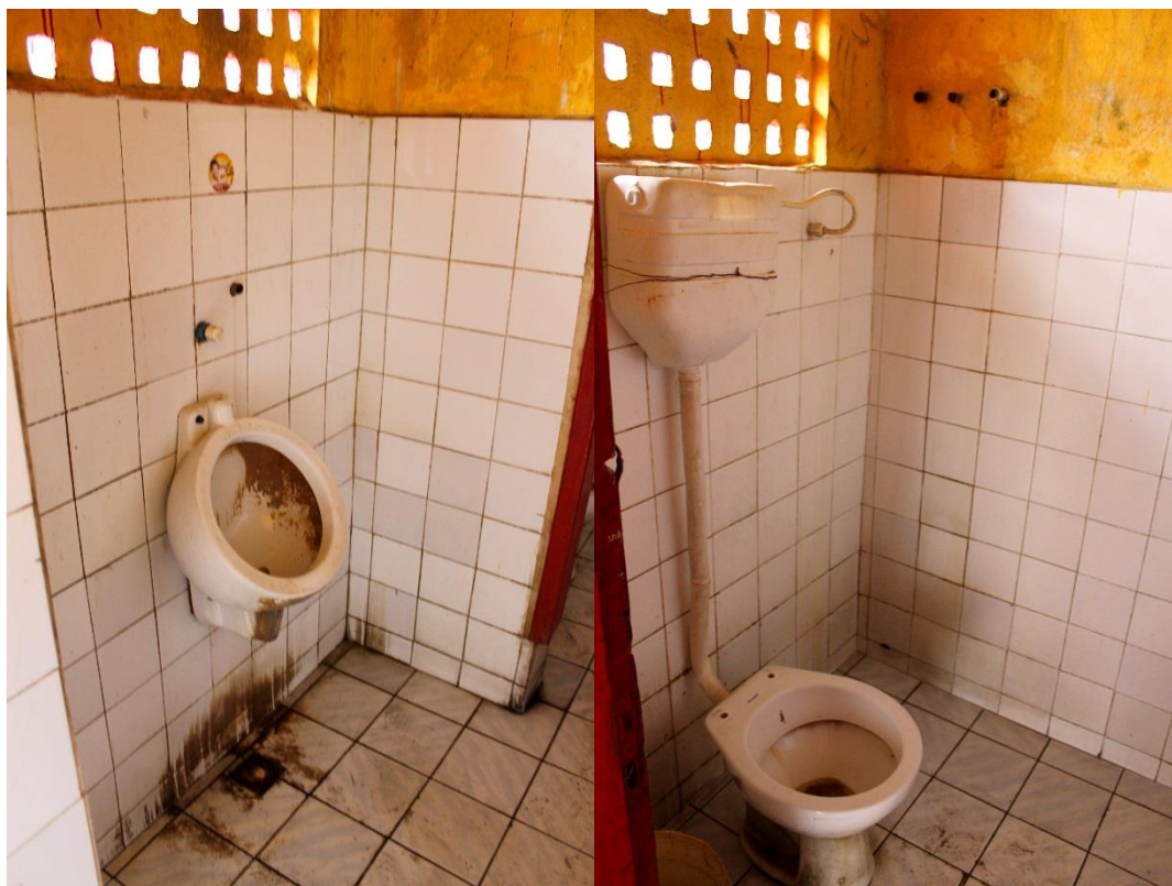
Figura 34 – Condições dos sanitários masculino da Feira Livre Casa Amarela Fonte: Rogério Cavalcanti, 2014
