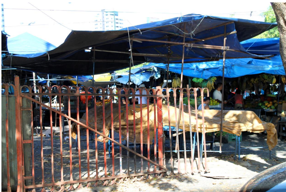
Figura 48 – Vista parcial da grade de proteção danificada no Pátio da Feira Livre Casa Amarela Fonte: Rogério Cavalcanti, 2015
