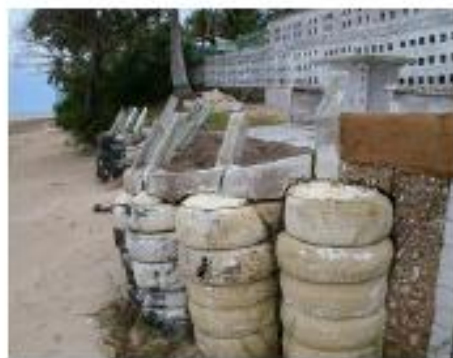
Contenção precária e irregular contra erosão marinha
