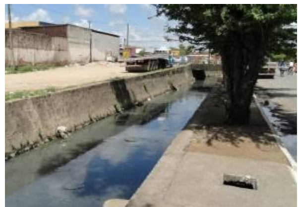
Figura 90: Canal poluído e mal protegido.
