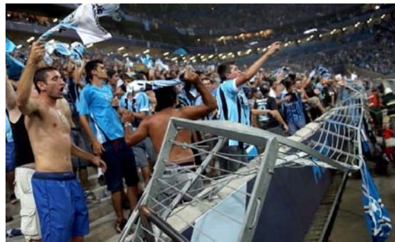
Figura 176 – Guarda-corpo quebrado pela torcida na Arena do Grêmio (fonte: www.esporte.uol.com.br )
