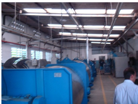
Figura 9 – Lavanderia (Máquinas de lavar)
