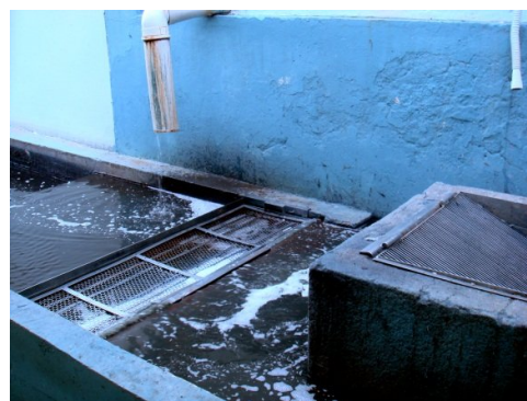
Figura 10 – Lavanderia (Tratamento da água)
