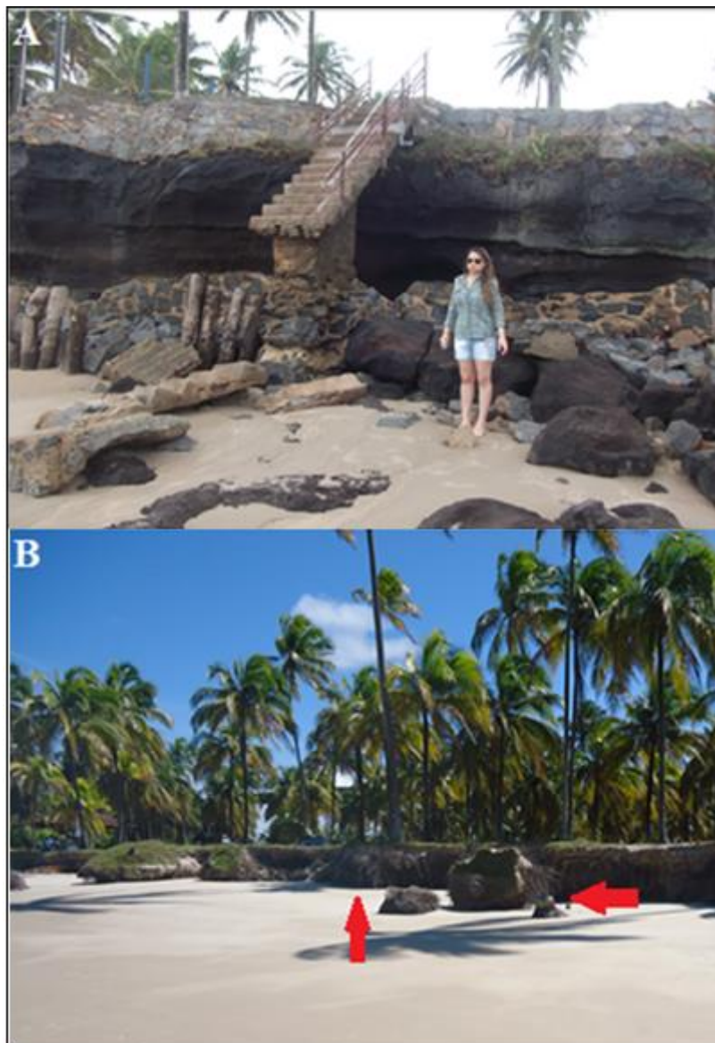
Figura 28: A – Ruínas de obras de contenção na praia de Guadalupe, B – Raízes expostas na praia de Toquinho.
