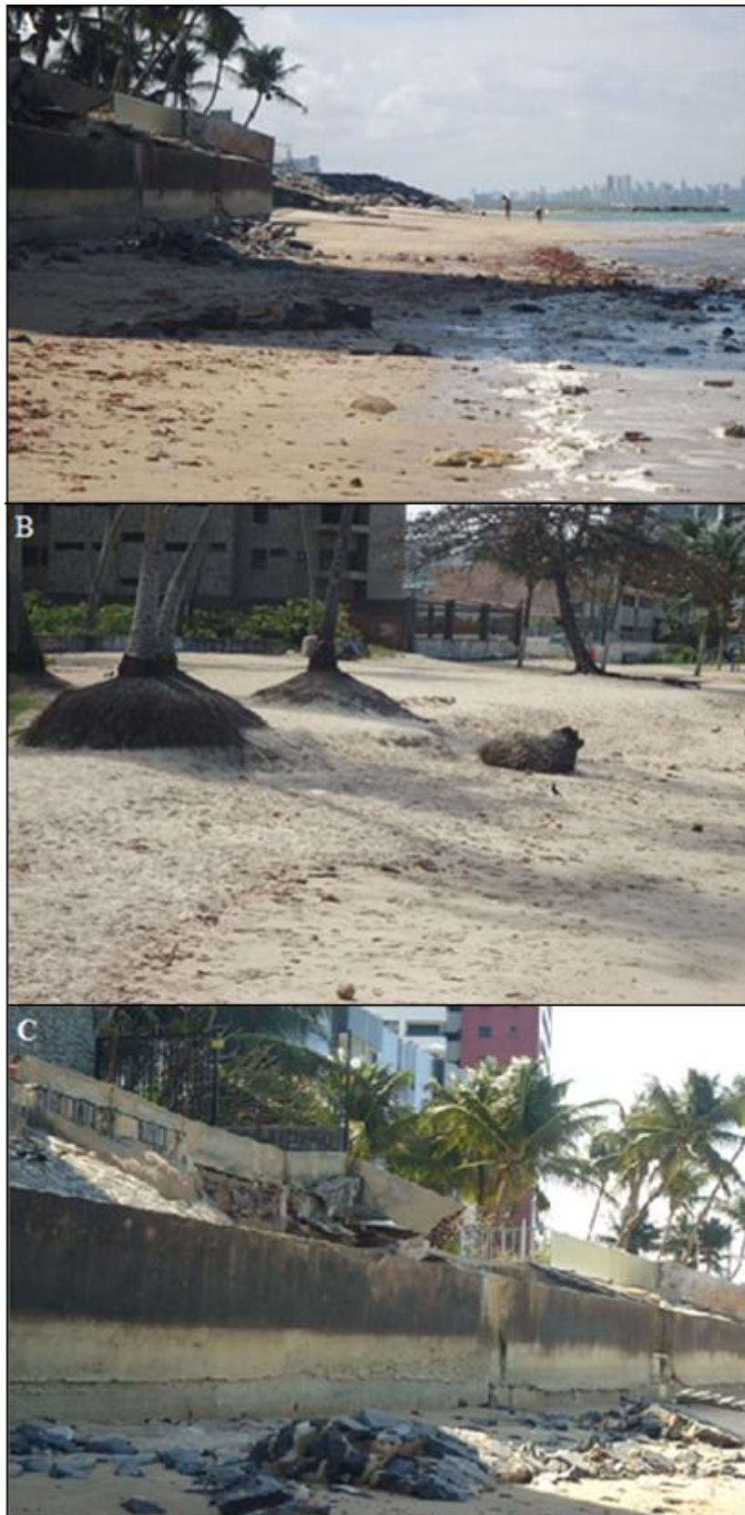
Figura 22: A, B e C – Indicadores de erosão (raízes de coqueiros expostas) e obras de contenção destruídas pela dinâmica costeira em Jaboatão dos Guararapes.
