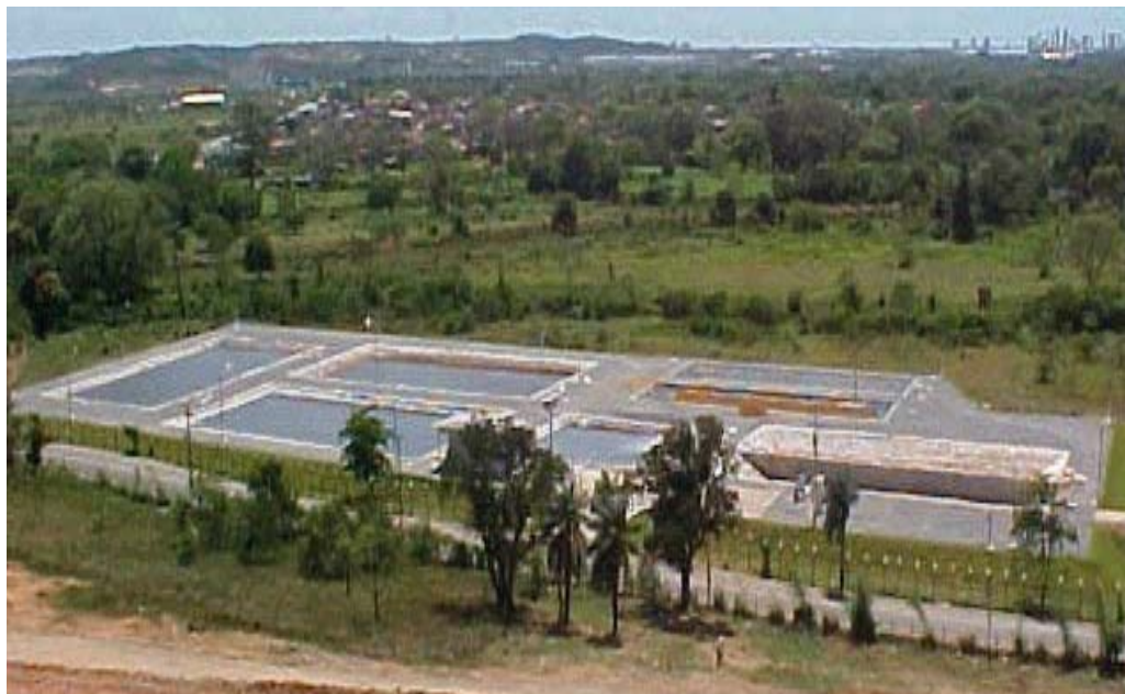
Figura 2.2: Estação de Tratamento de Chorume do Aterro da Muribeca.
